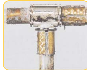
Uniones a presión de latón con tubería de plástico rotas después de un proceso de corrosión bajo tensiones (3)
